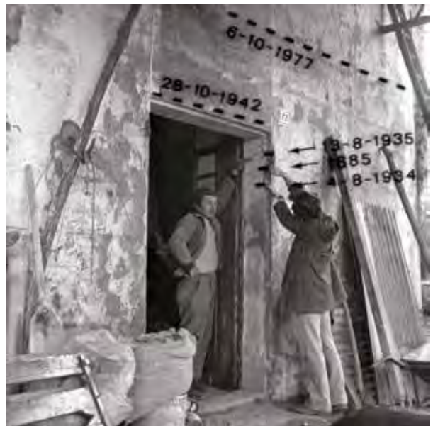
Castelletto d'Orba (Alessandria). Edificio del molino lungo il torrente Albedosa con le diverse indicazioni delle altezze raggiunte dalle acque, tutte largamente superate dalla piena dell'ottobre 1977.
